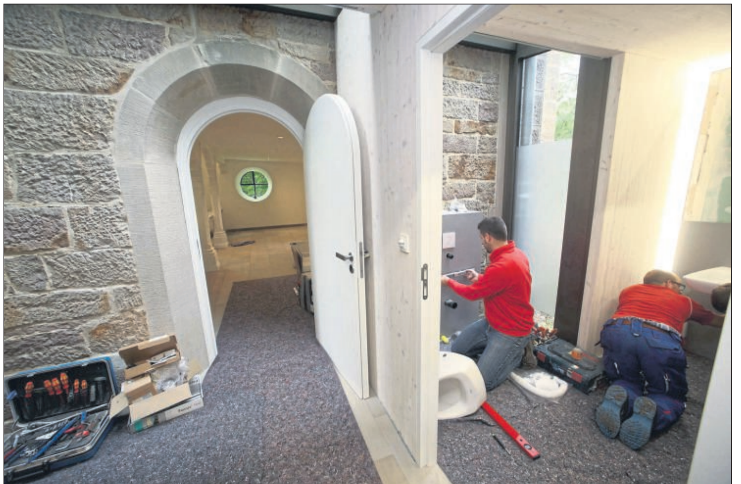
Ganz neu: Weil in der Kirche kein Platz ist, wurden in einem Anbau Küche, Heizung und Toilette untergebracht. Am Mittwoch erfolgten noch Montagearbeiten. Eines der Rundfenster wurde von Maurern und Steinmetzen zum Durchgang (links) erweitert. Fotos: Thiele
