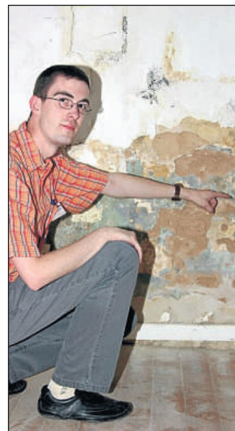
Wasserschaden: Dirk Altmann, Mitglied im Verein Generationenhaus, zeigt marode Stellen in der Wand.
